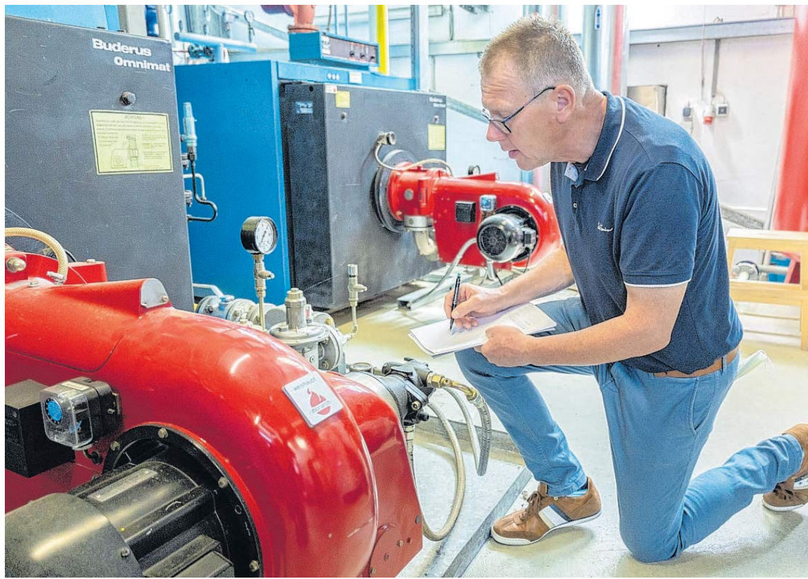
Volker Lindner ist als Technischer Leiter im Klinikum auch für die Systemkontrolle im Blockheizkraftwerk zuständig. Dort erzeugt Obergöltzsch 50 Prozent des Energiebedarfes selbst. Allerdings wird dieses mit Gas betrieben.
